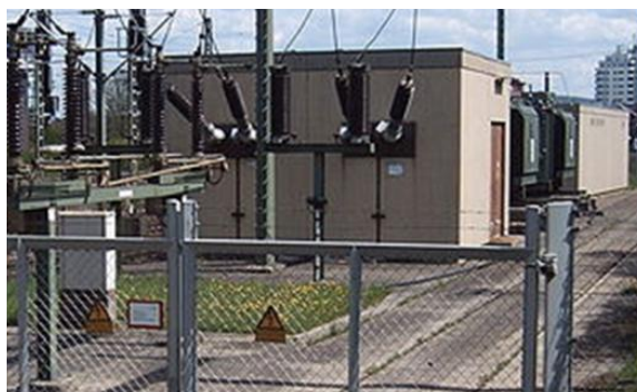
Figure 9 : Sous-station (Source : Wikipedia)
