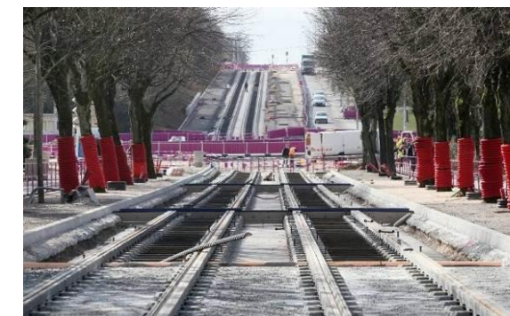
Figure 7 : Travaux de construction de la plateforme du Tramway – Dijon (Source Egis Rail)
